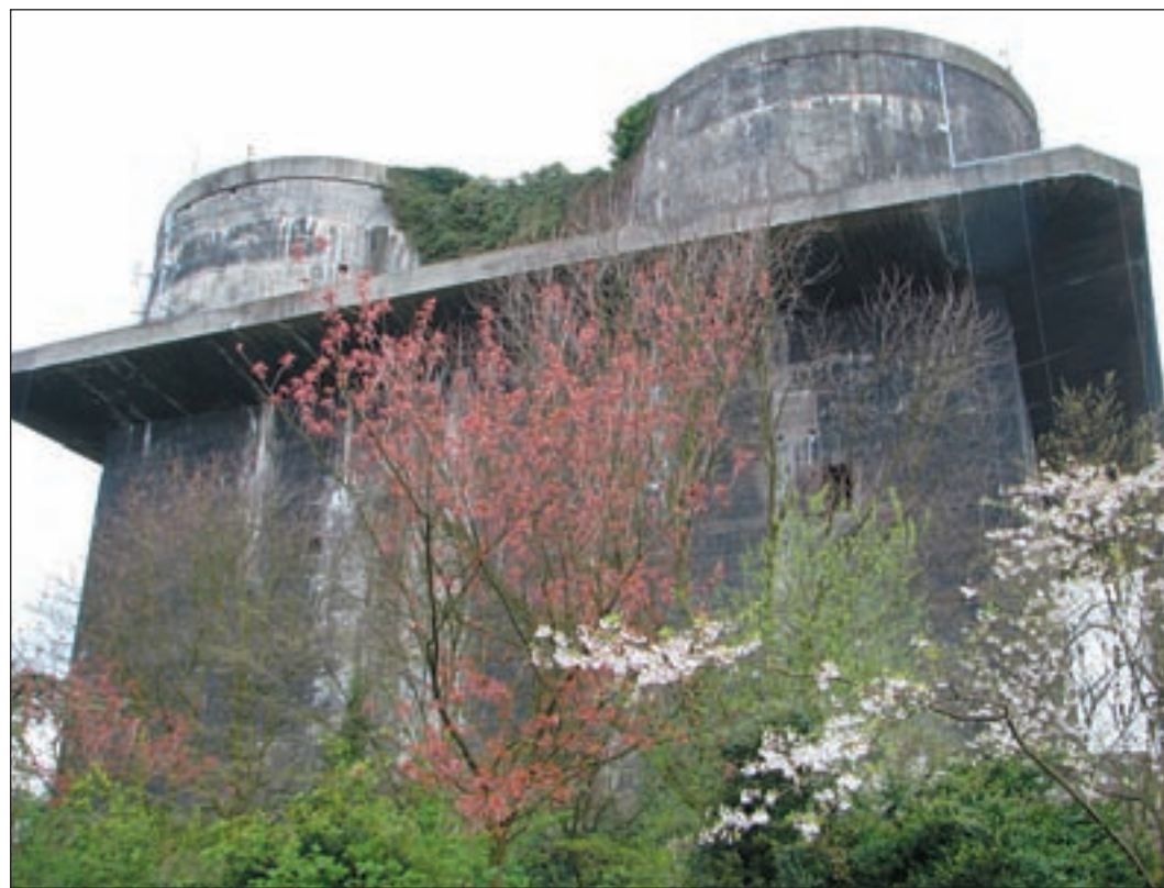
Der alte Flakbunker an der Neuhöfer Straße bietet in seinem jetzigen Zustand keinen schönen Anblick.
